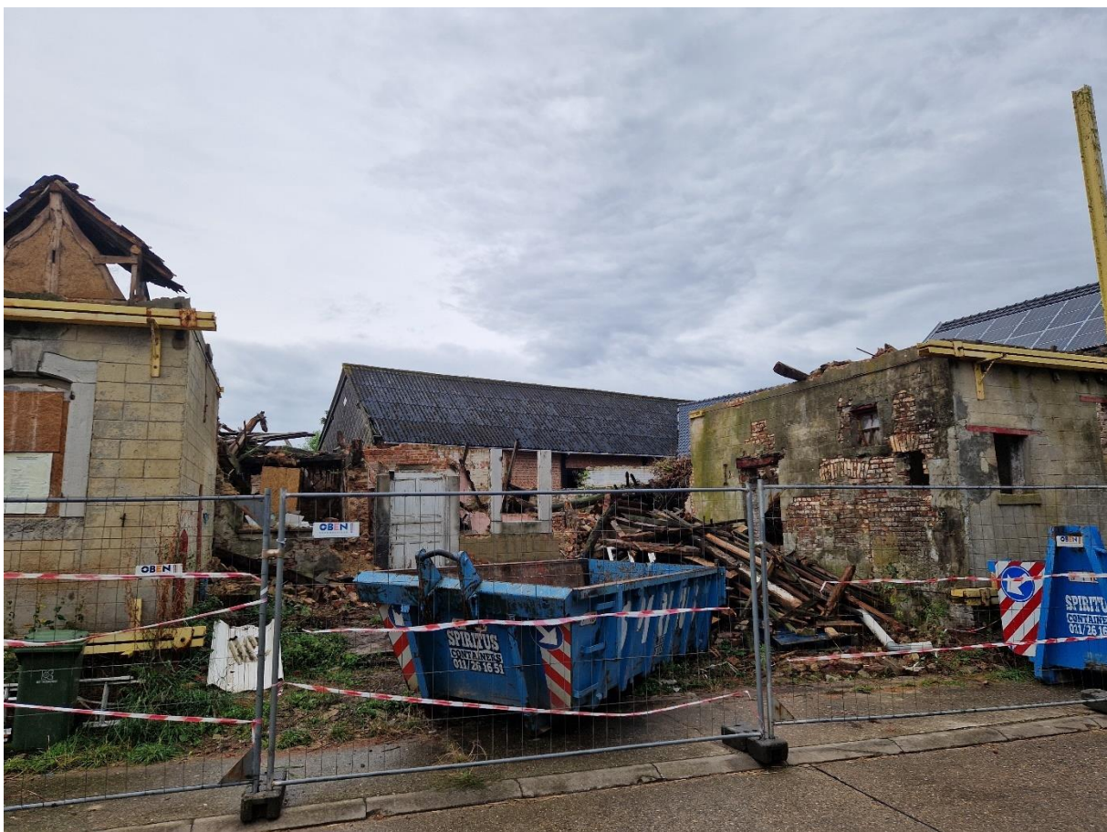
Fig. 88: Ten tijde van de opmaak van deze studie zijn inmiddels grote delen verdwenen en staan er werfhekkens en afvalcontainers. Het gebouw blijkt nog deels uit een vakwerkconstructie te bestaan.
